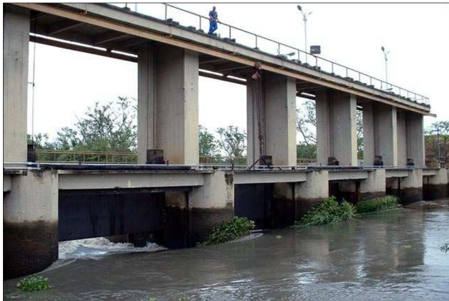
Figura A.7 – ETA Guandu captação - CEDAE
